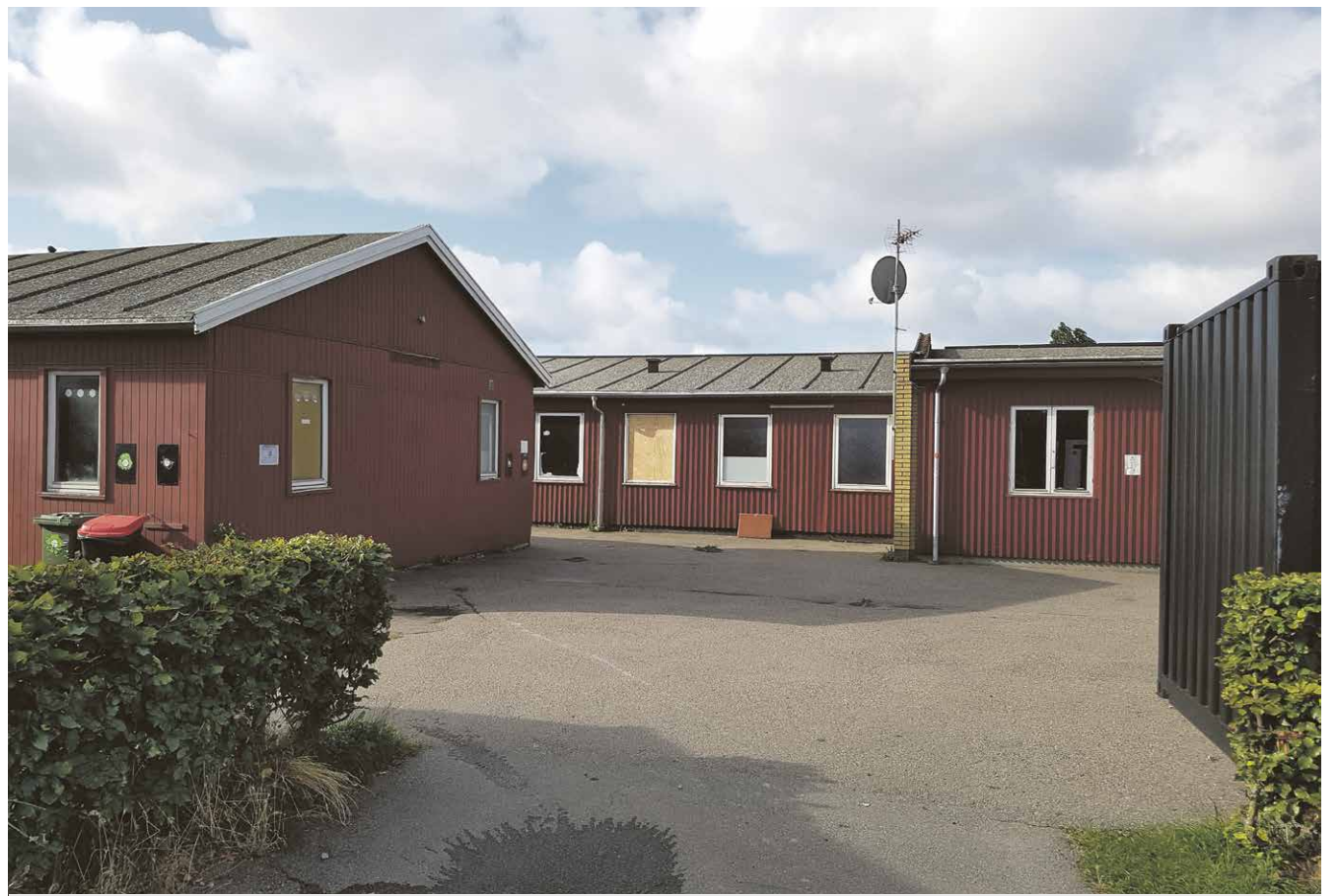
De gamle barakker på Kløvermarksvej trænger til udskiftning.
